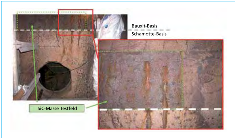
Bild 13: Massive Haltbarkeitsdefizite verschiedener Betone
